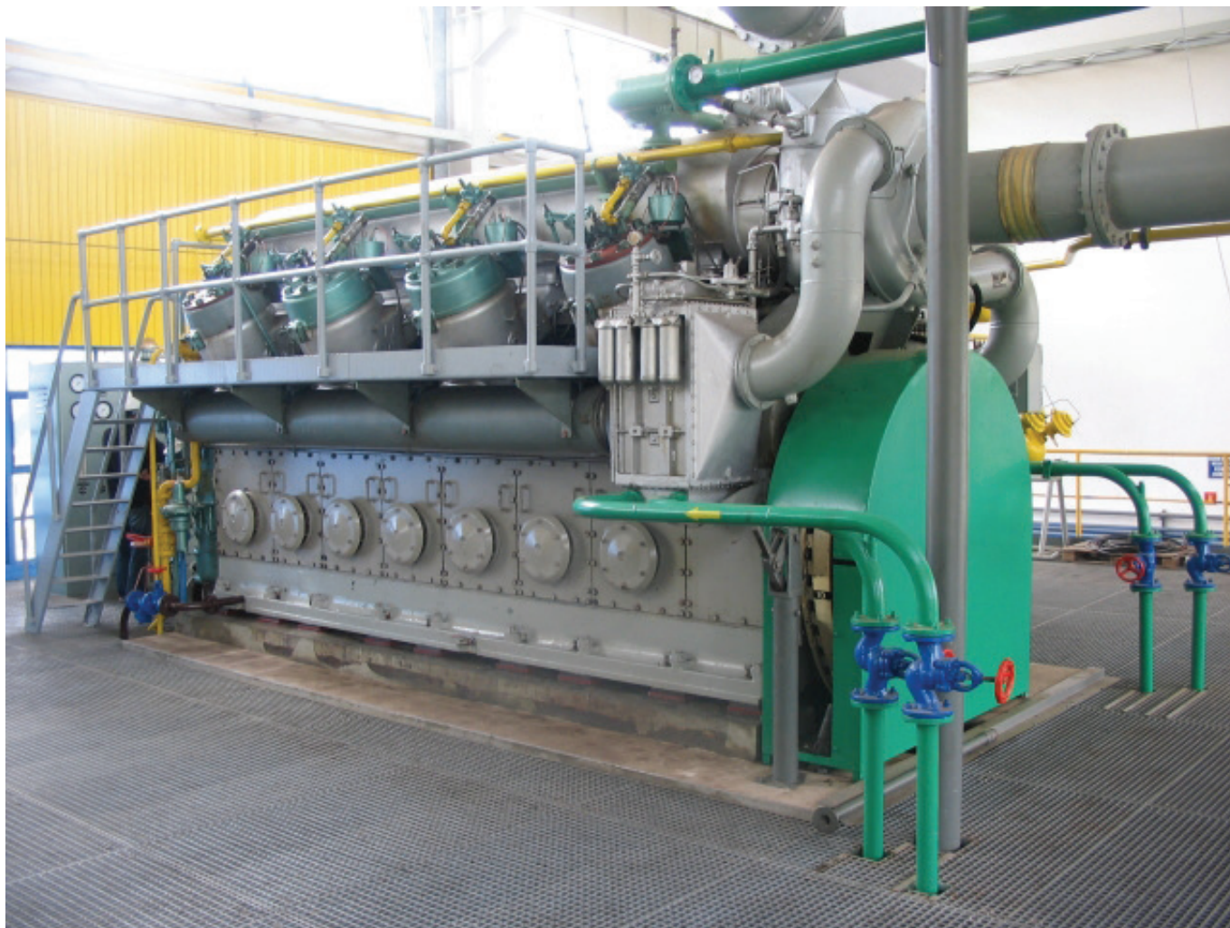
Газовый двигатель LSV 16 на электростанции
