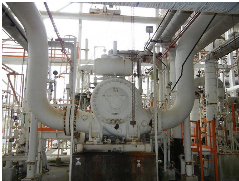
Центробежный компрессор RFB 24 с приводом от турбины Elliot мощностью 4800 лс при 7550 об/мин.
